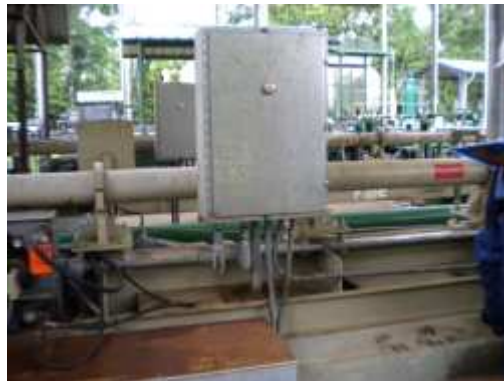
Figura2.60 Tablero bomba P601D vista externa.
