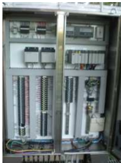
Figura2.43 Tablero de control vista interna.
