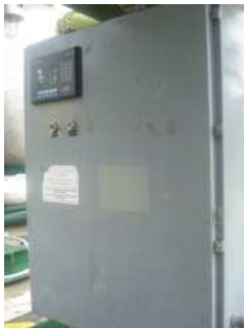
Figura2.18 Tablero de control.
