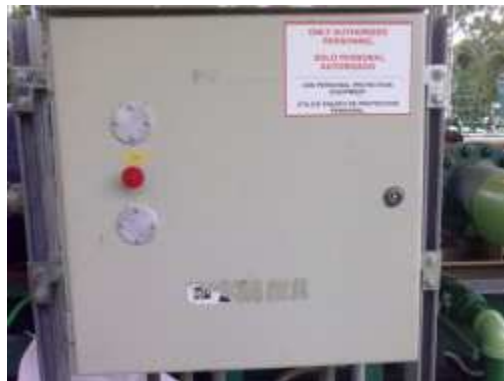
Figura2.54 Tablero bomba P612B vista externa
