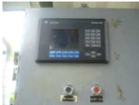
Figura2.20 Panel View existente.
