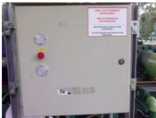
Figura2.22 Tablero bomba P612B (vista externa).
