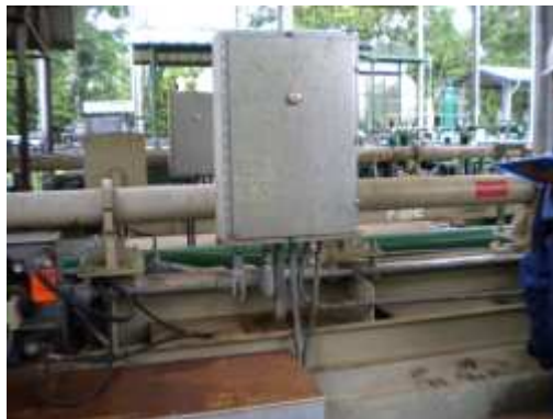
Figura2.24 Tablero bomba P601D (vista externa).
