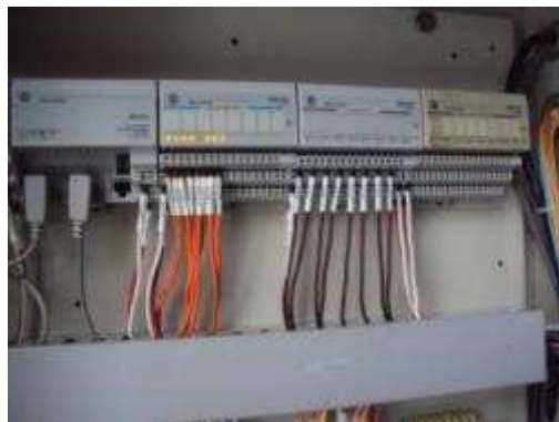
Figura 3.12. Distribución de Módulos tablero de la bomba P612B.
