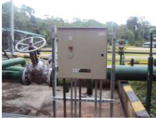
Figura2.21 Tablero bomba P612A (vista externa).
