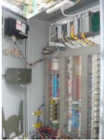
Figura2.19 Tablero de control existente (vista interna).
