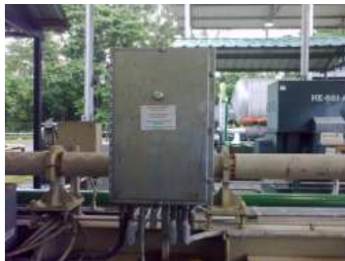
Figura2.58 Tablero bomba P601C vista externa.
