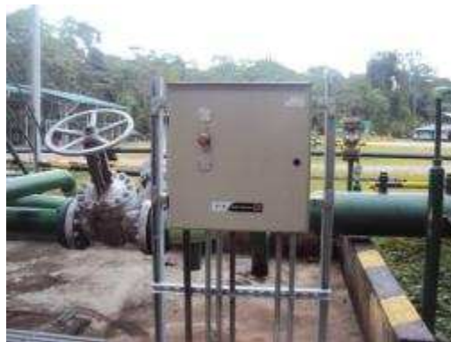
Figura2.52 Tablero bomba P612A vista externa.
