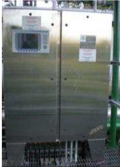
Figura2.41 Tablero de control vista externa.
