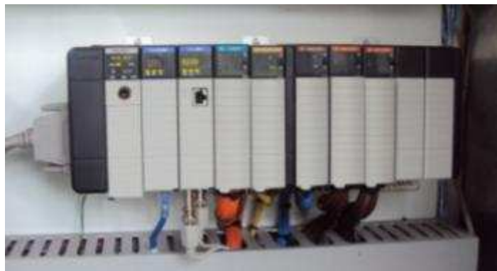
Figura 3.8. Distribución de Módulos del PLC
