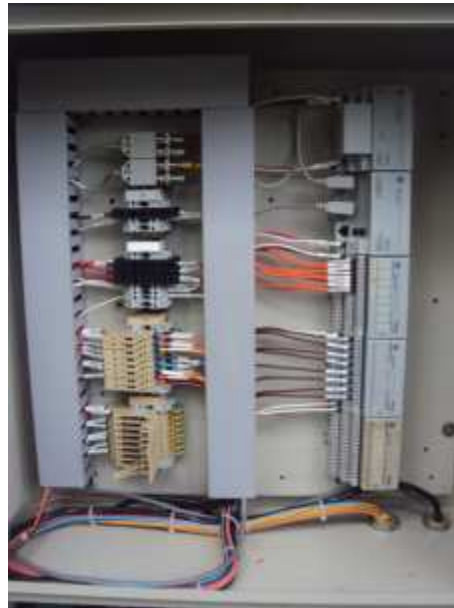
Figura2.55 Tablero bomba P612B vista interna.
