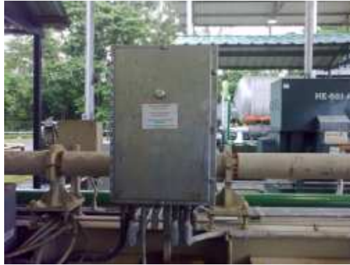
Figura2.23 Tablero bomba P601C (vista externa).
