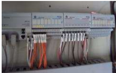
Figura 3.10. Distribución de Módulos del Tablero de la Bomba P612A.
