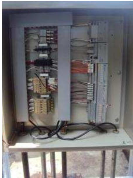
Figura2.53 Tablero bomba P612A vista interna.
