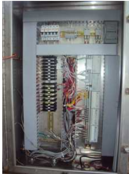
Figura2.61 Tablero bomba P601D vista interna.
