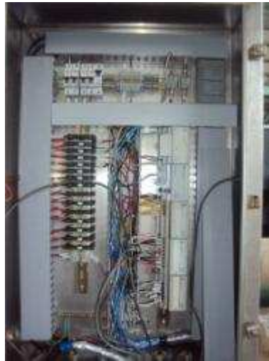
Figura2.59 Tablero bomba P601C vista interna.
