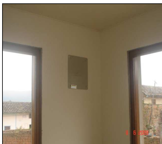
Figura 14. Caja de revisión de Instalaciones eléctricas Apícola Santa Anita
