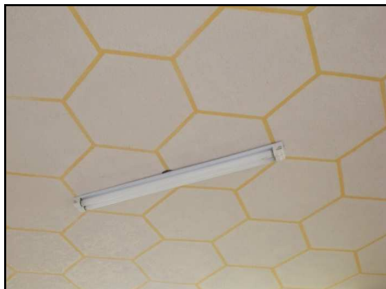
Figura 36: Luminaria fluorescente sin protección Área de Envasado y Etiquetado.
