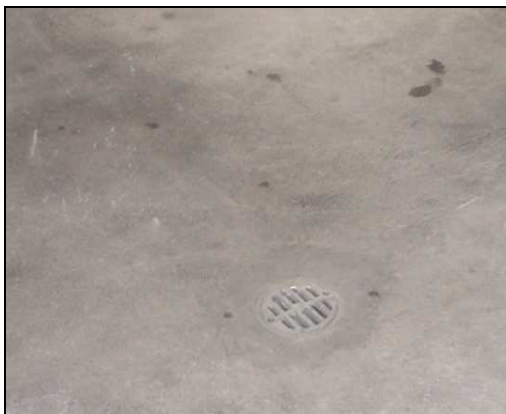
Figura 17: Drenaje de evacuación de desechos líquidos Apícola Santa Anita
