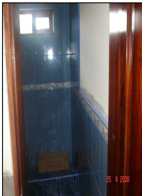
Figura 16. Instalaciones Sanitarias sin acabados Plantel de Extracción y Envasado Apícola Santa Anita
