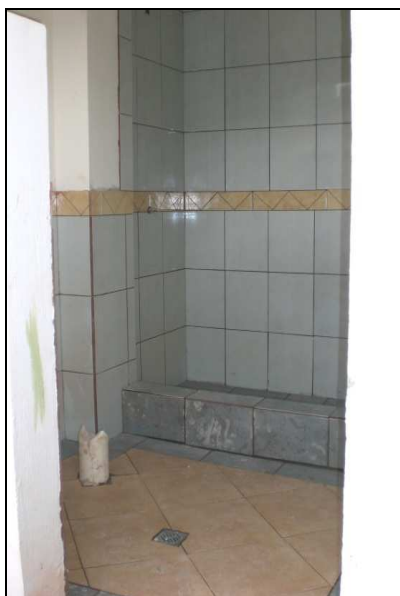
Figura 37: Instalaciones Sanitarias Apícola PRONAAPIC.
