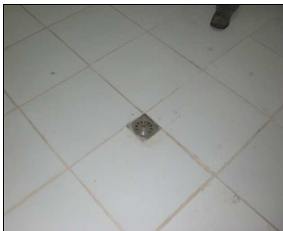
Figura 34: Drenaje de evacuación de residuos líquidos Apícola PRONAAPIC
