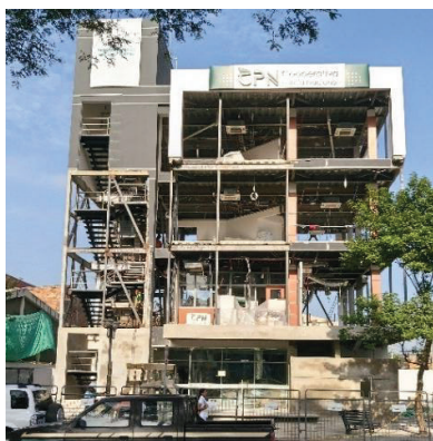
Fotografía 4. 16. Daños en la estructura del edificio.
