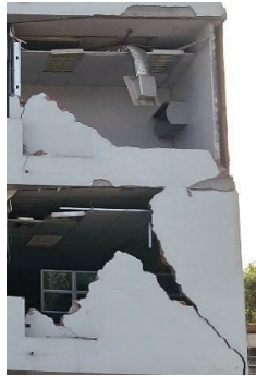
Fotografía 4. 17. Daños en la mampostería de bloque del edificio.
