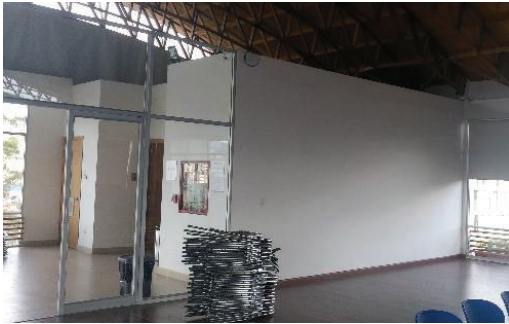
Fotografía 4. 18. Paneles de Hormi2 luego del sismo.
