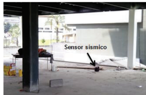
Fotografía 3. 1. Ubicación del sensor sísmico. (18/12/2014).
