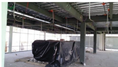
Fotografía 3. 2. Materiales acumulados en la estructura. (27/08/2015).
