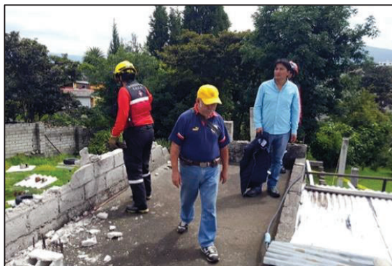
FIGURA 1.11 DAÑO EN VIVIENDA EN EL CANTÓN RUMIÑAHUI
