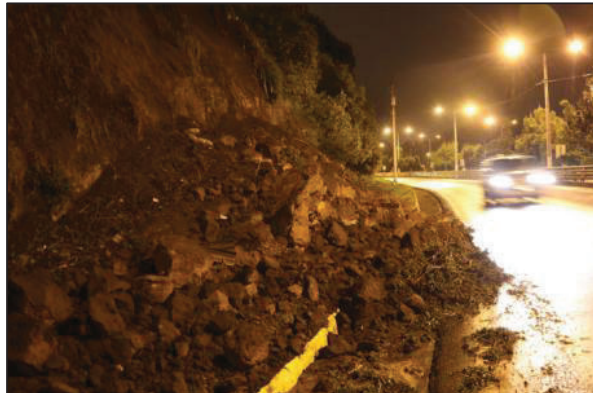
FIGURA 1.10 DERRUMBE EN LA AUTOPISTA RUMIÑAHUI
