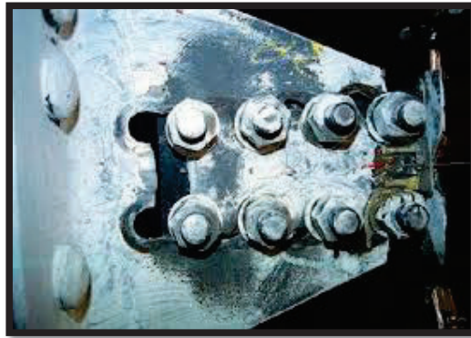
Figura 2-33.- Falla de bloque por cortante.
