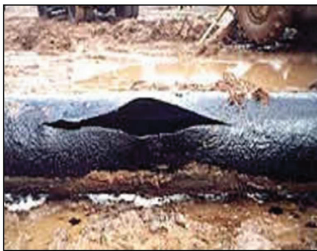
Gráfico 2.13 Tubería afectada por corrosión
