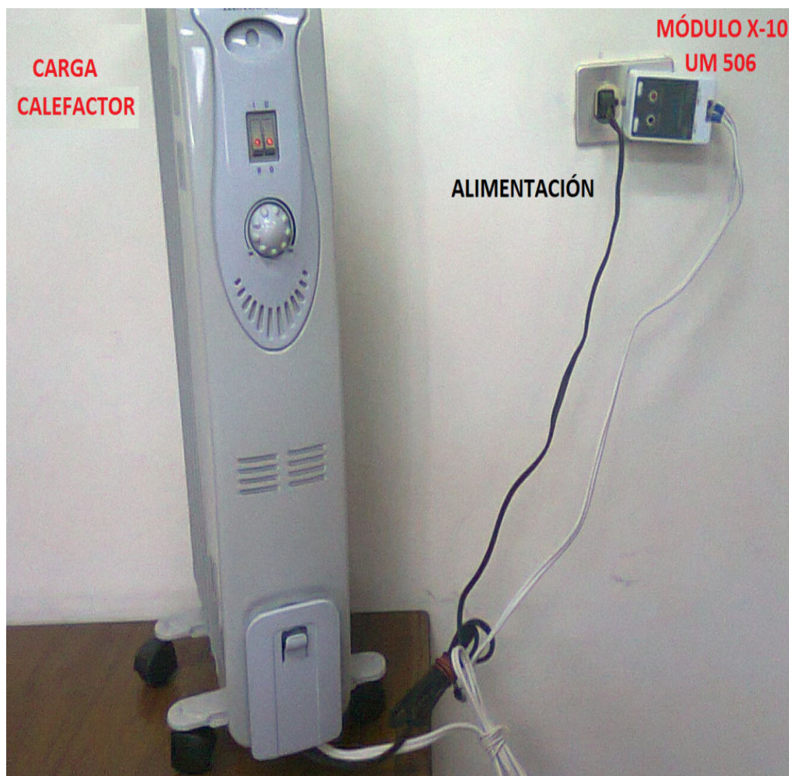
Figura 2.18 Conexión del módulo X-10 al calefactor
