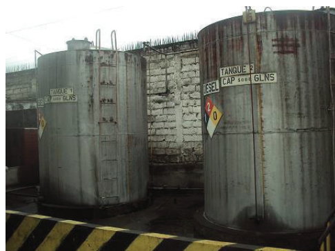
Figura 2.10. Tanques de almacenamiento de diesel planta 4 ECASA
