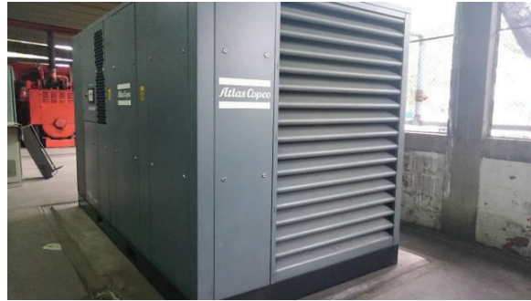
Figura 3.7. Compresor Atlas Copco GA 315 VSD (Fuente: Fotografías ECASA, 2016)
