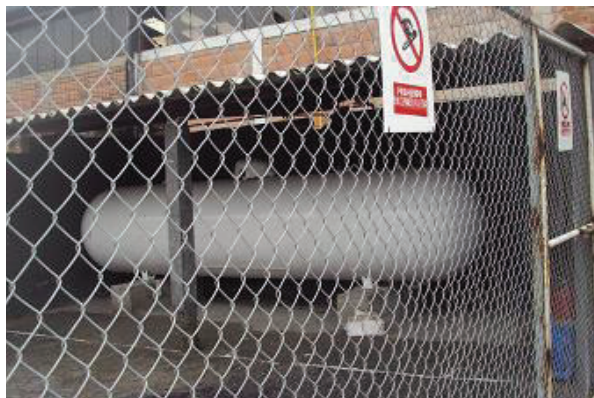
Figura 2.11. Bombona de almacenamiento de GLP planta 5 ECASA
