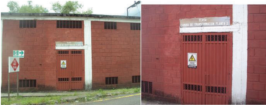
Figura 2.9. Cámara de transformación planta 4 y 2 ECASA
