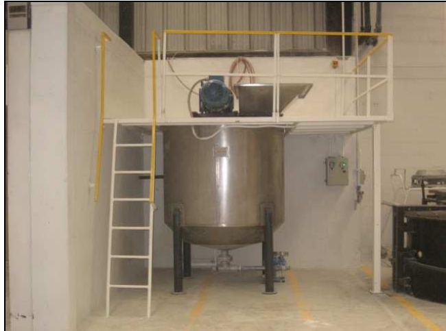
Figura 2.21. Mezcladora instalada para el proyecto en el área de fabricación de esmaltes.
