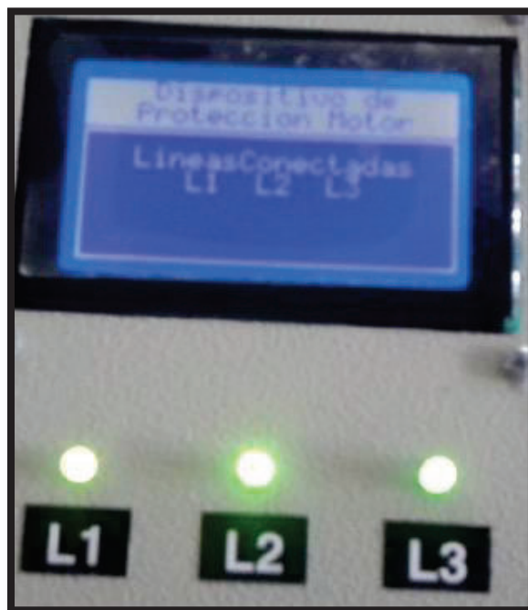
Figura 2.30 Pantalla y señales luminosas de líneas conectadas. [Elaboración propia]
