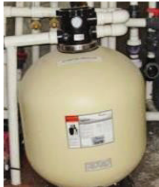
Figura 4.4. Filtro de la piscina
