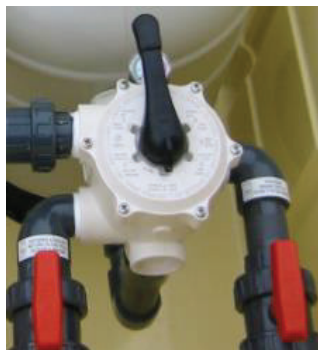
Figura 4.5. Válvula selectora de la piscina
