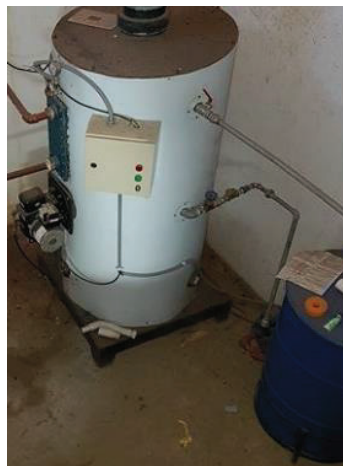
Figura 4.3. Caldera de la piscina Fuente: Propia
