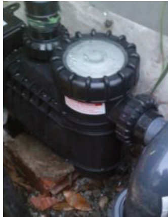
Figura 4.2. Bomba de la piscina Fuente: Propia
