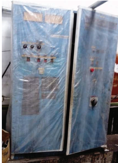
Figura 2.2: Tablero de control anterior.
