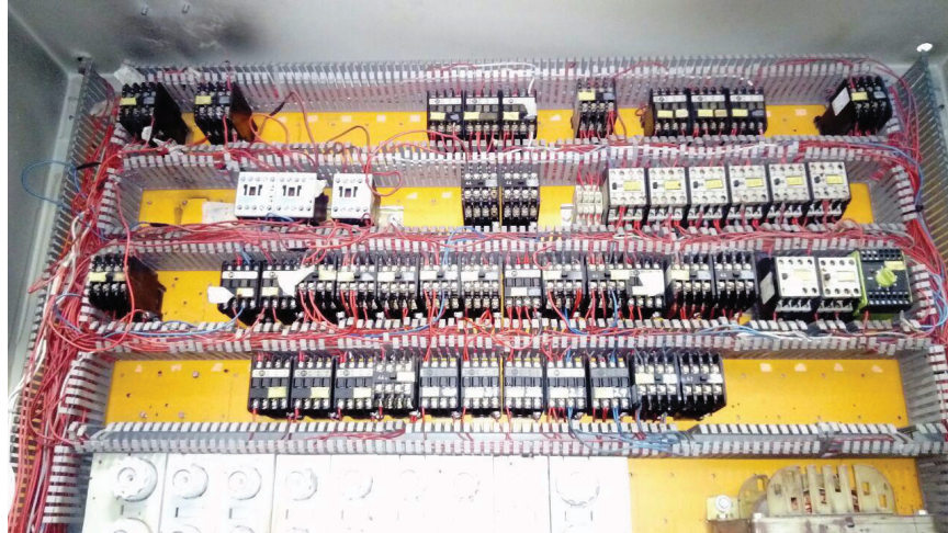
Figura 2.4: Elementos de control obsoletos.
