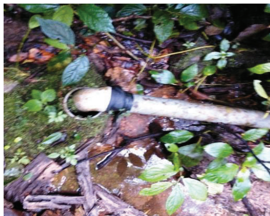
FOTOGRAFÍA 11. SISTEMA DE TUBERÍAS ABANDONADO
