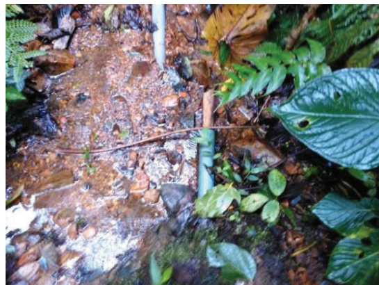
FOTOGRAFÍA 12. TUBERÍAS ENTERRADAS BAJO CEMENTO.
