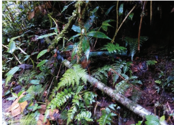
FOTOGRAFÍA 13. TUBERÍA DE CONDUCCIÓN VERTIENTE LAS ISLAS
