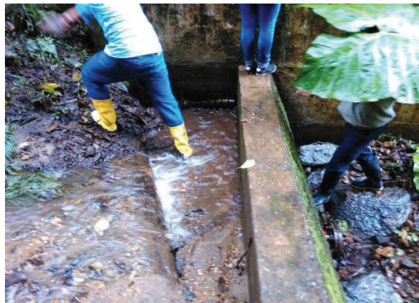
FOTOGRAFÍA 14. REJILLA. TOMA LATERAL RÍO SAN CARLOS
