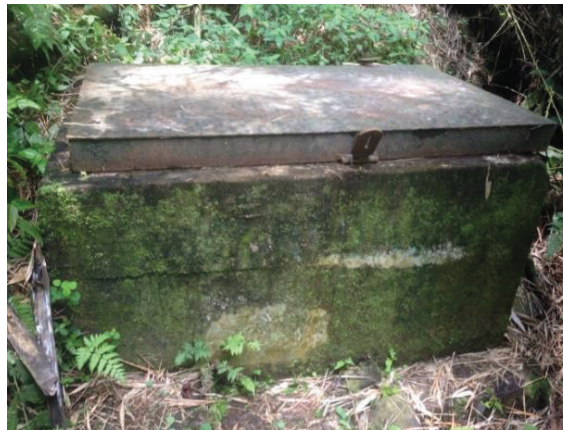
FOTOGRAFÍA 5. TANQUE DE CAPTACIÓN LAS GUADUAS
