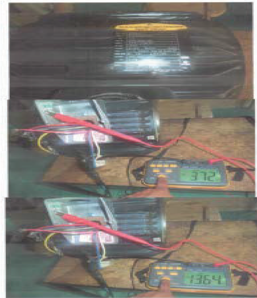
Figura AV.4 Registro fotográfico de puesta en marcha de la bomba jockey
