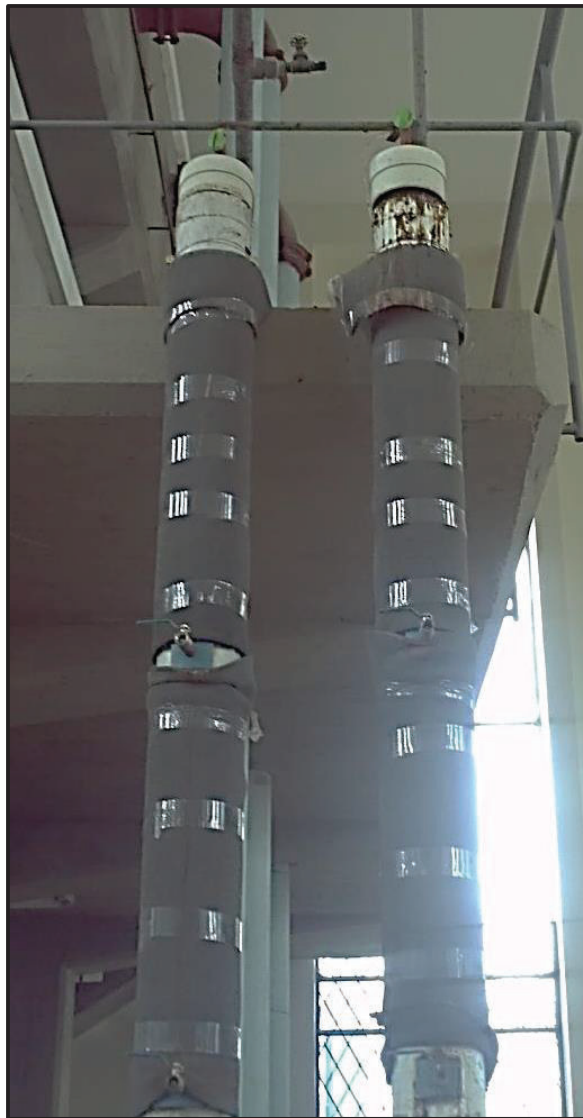
FIGURA 3.1. REACTORES ANAEROBIOS INSTALADOS
