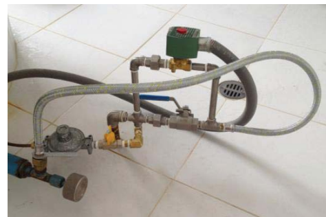
Fig. 1.2: Válvulas de gas
