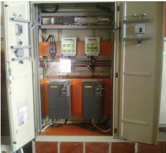
Fig. 11. Tablero de control de presión constante
