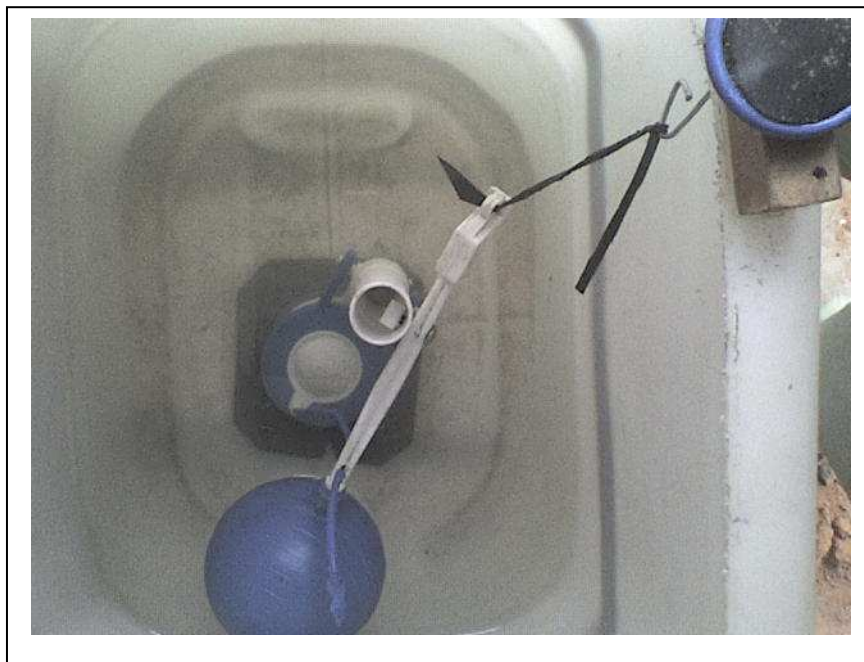
Imagen2.- Tanque de recolección de aguas grises.
