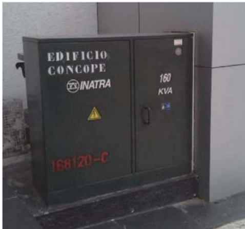
Fig. 1 Transformador Pad Mounted de la EEQ S.A.
