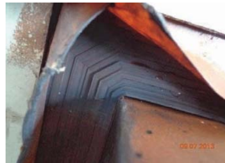
Fig. 3 Transformador averiado INATRA
