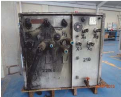
Fig. 5 Transformador averiado RYMEL
