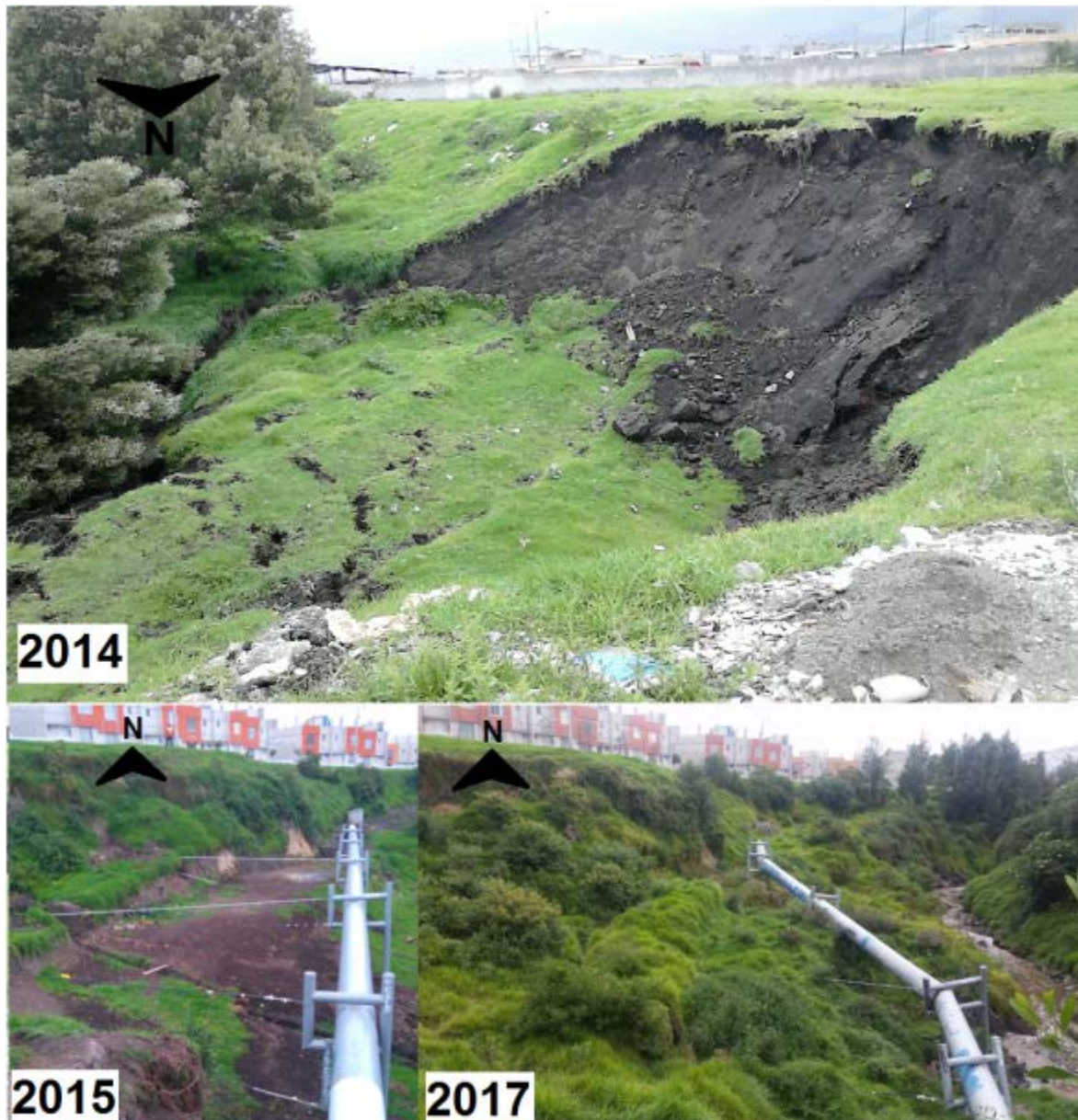
Figura 1.1. Avance de un deslizamiento ubicado frente al Barrio Terranova, calle S37C. Fuente: Administración Zonal Quitumbe
