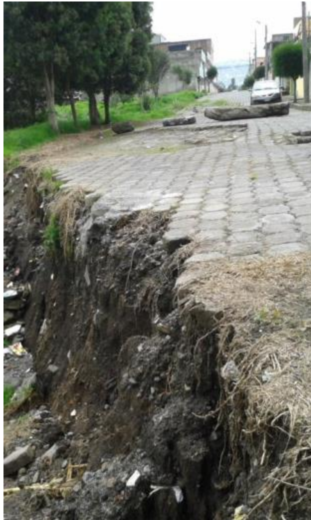
Figura 1.2. Calle S37C con daño en el adoquinado por avance del escarpe del deslizamiento. Fuente: Administración Zonal Quitumbe, año 2014
