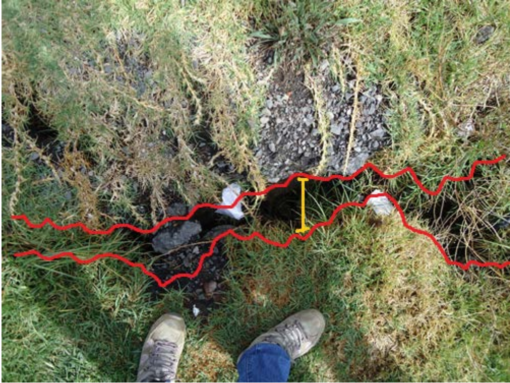
Fotografía 5.4. Grietas de tensión en el escarpe donde se encuentra el parqueadero de las volquetas.
