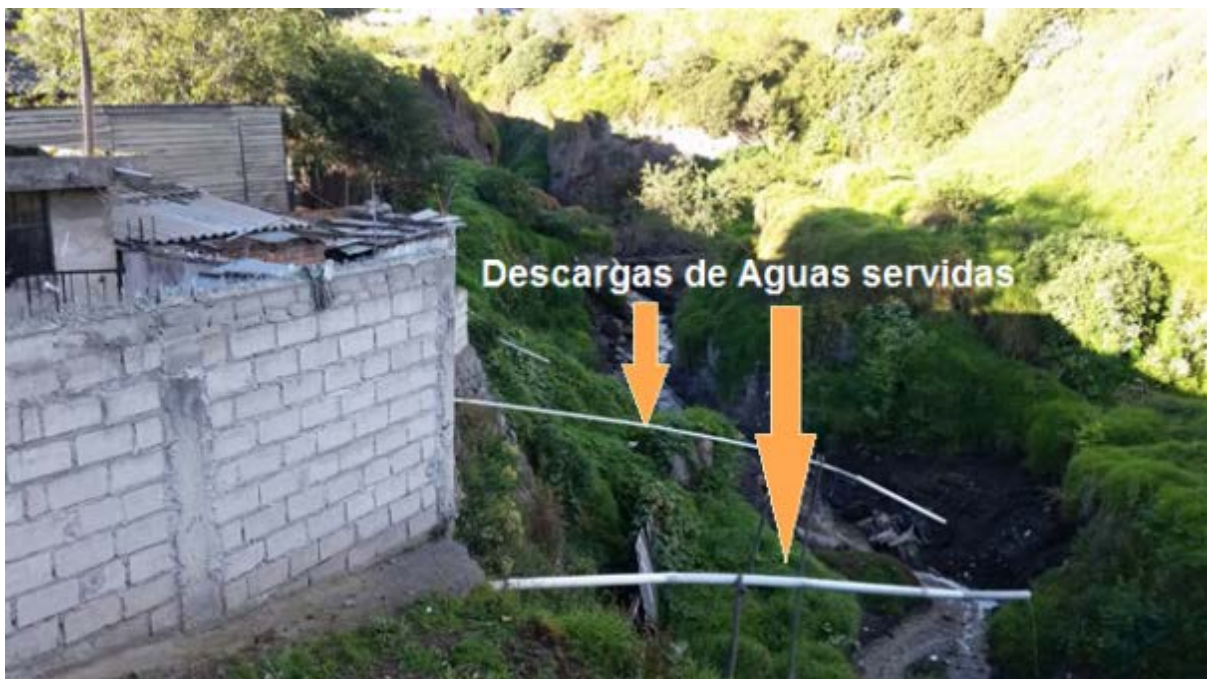
Fotografía 5.2. Descargas de aguas servidas por parte de la casa en el perfil “C”.
