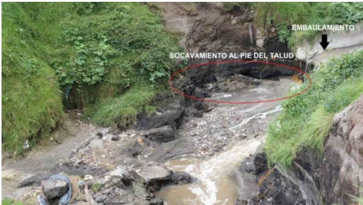
Fotografía 5.6. Socavamiento al pie de talud.
