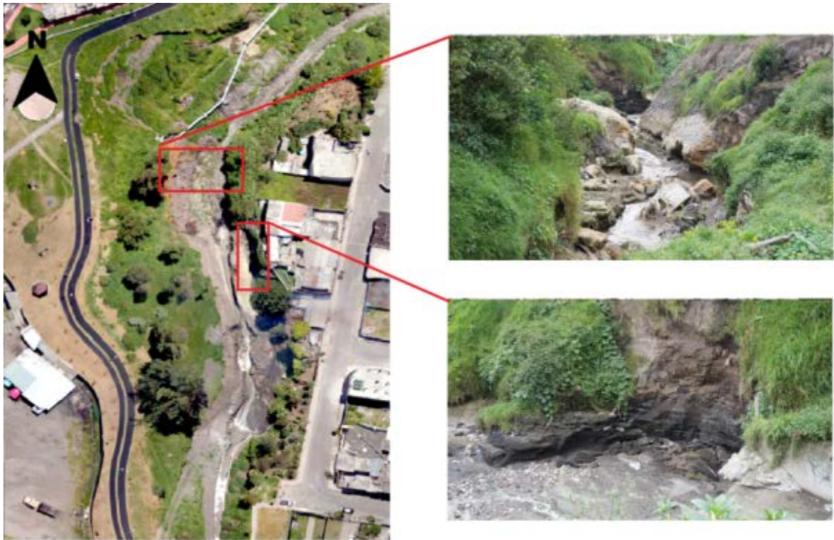
Figura 5.7. Socavación al pie de talud.
