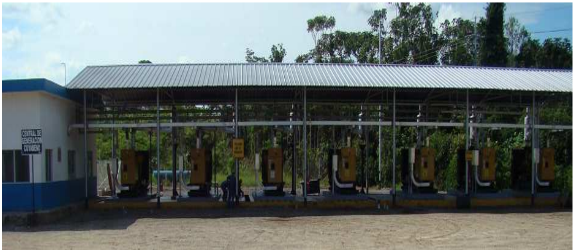
Figura 3.1. Central de Generación Cuyabeno
