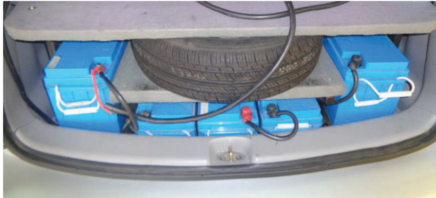
Figura 1.3. Banco de baterías. (Fuente: Propia, 2016)
