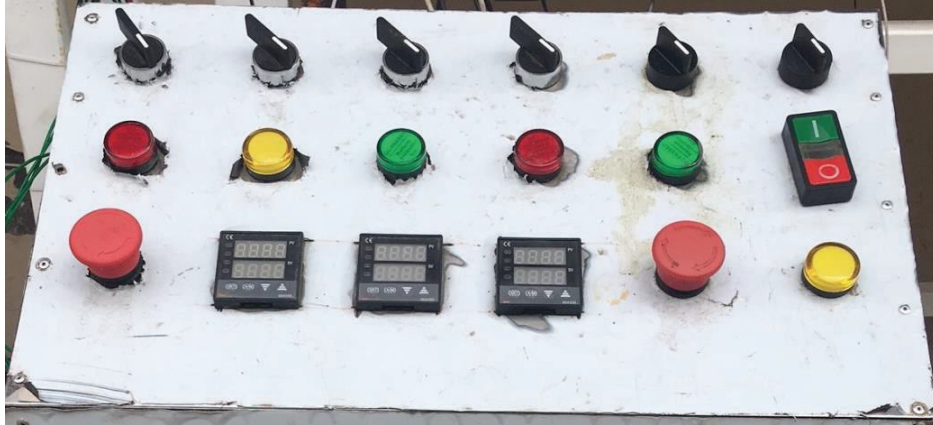
Figura 41. Elementos tablero eléctrico. (Fuente: Adaptado de propia fuente).
