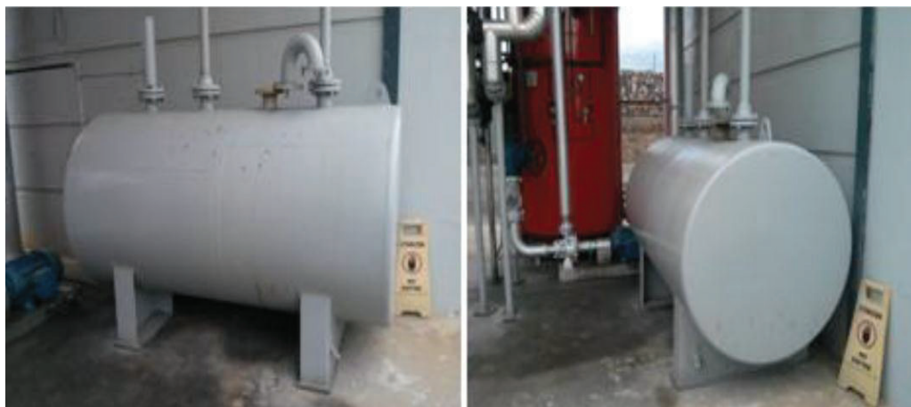
Figura: 2.23. Tanque de almacenamiento para aceite térmico
