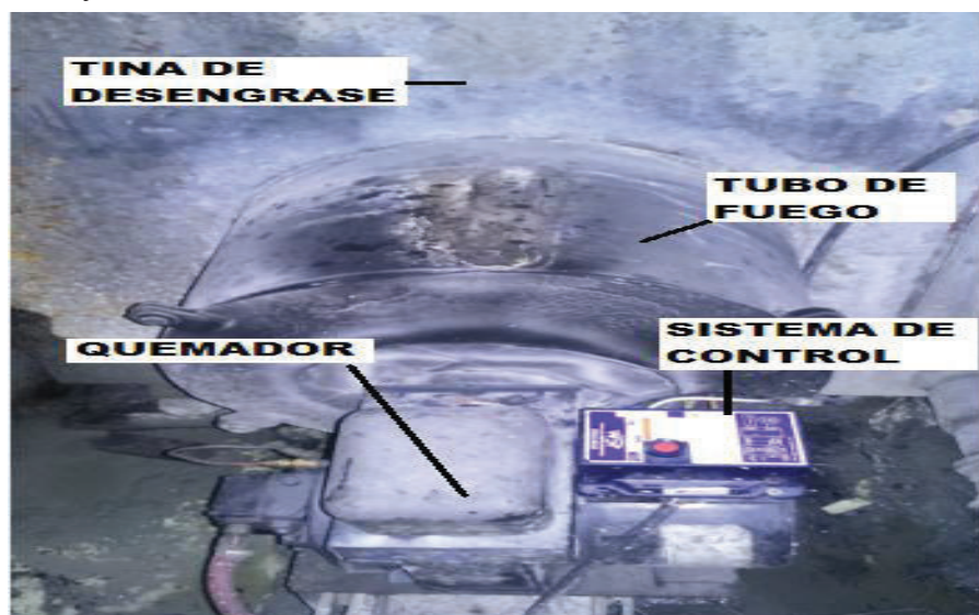
Figura 1.22. Daños Provocados por el Reboso de Líquido Fuente: Propia, 2016
