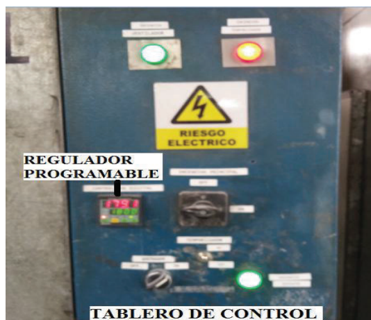
Figura 1.20. Tablero de Control para hornos
