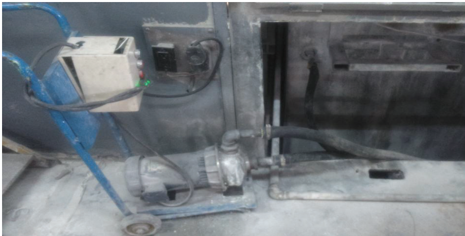
Figura 1.9. Bomba de Recirculación Fuente: Propia, 2016
