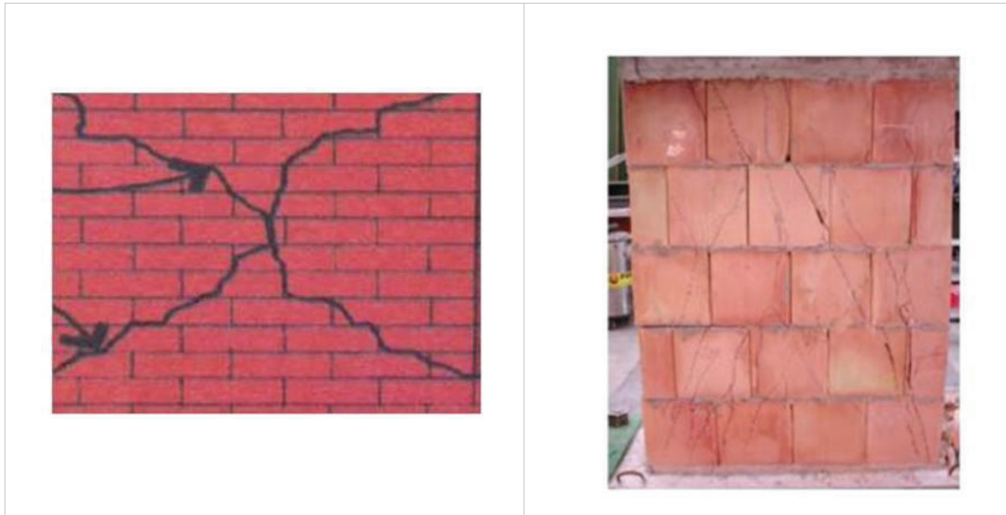
FIGURA 2.2 FALLAS A CORTANTE POR TRACCIÓN DIAGONAL
