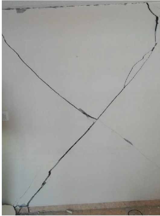
FOTO 2.1 DAÑO A CORTE EN MAMPOSTERÍA ATACAMES
