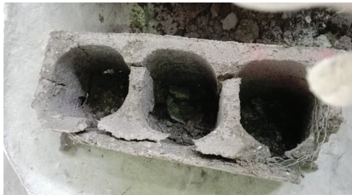
FOTO 3.5 FALLA EN LOS TABIQUES DE LOS BLOQUES EVITANDO LA MALLA
