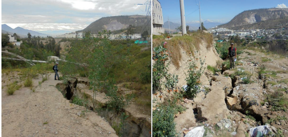
Fotografía 1.2 Grietas métricas, Barrio Atacaba
