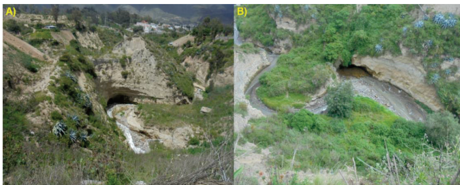
Fotografía 5.6 Socavamiento al pie del talud producto del incremento del caudal líquido.
