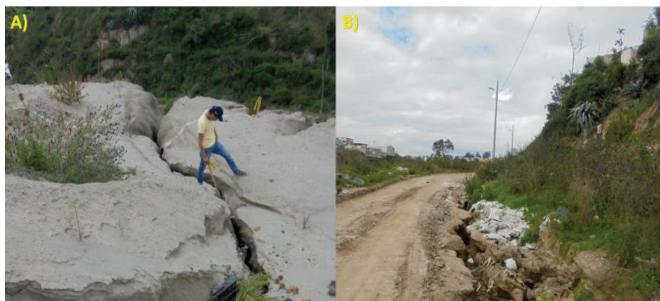
Fotografía 5.5 Lluvias intensas. A) Fpd en la unión Qda. Almeida con el Río Pusuquí. B) Fpt en la vía del alcantarillado
