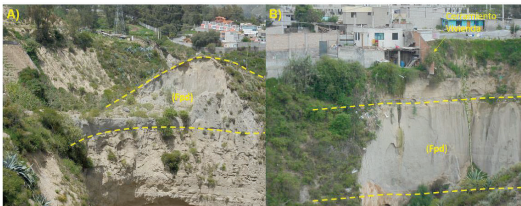
Fotografía 4.4 Depósitos de Flujo Piroclásticos Dacítico. A) Antigua cantera ubicada al margen izquierdo de la Qda. Almeida. B) Casa sobre ladera perpendicular ubicada al margen derecho de la Qda. Almeida
