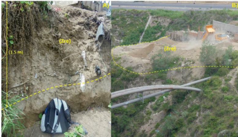
Fotografía 4.7. A) Zona de relleno ubicada en el camino del alcantarillado del AID. B) Zona en proceso de relleno al borde de la Qda. Almeida
