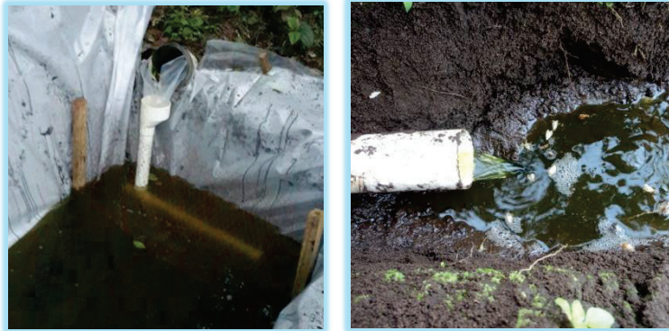
IMAGEN 3.3. Entrada y salida de la laguna de maduración de bajo calado.
