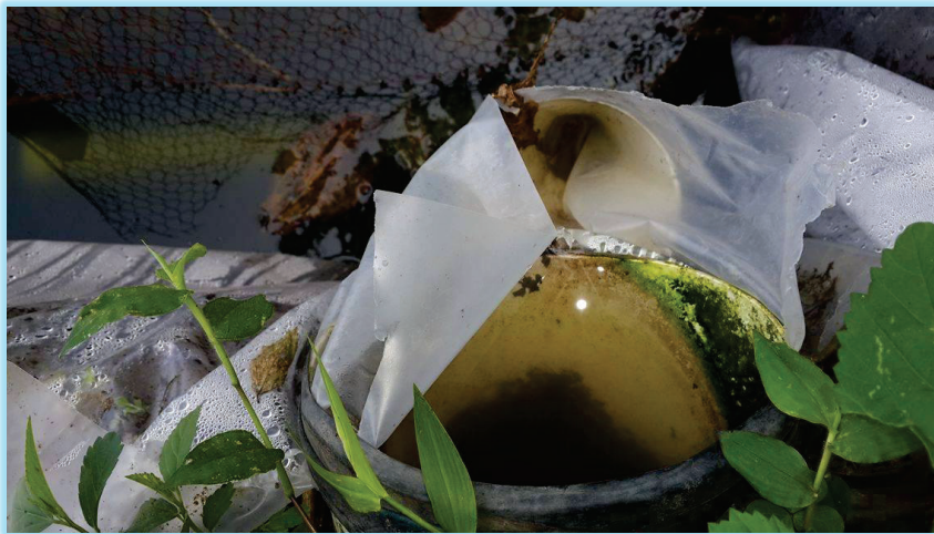
IMAGEN 3.2. Salida de agua del Biodigestor anaerobio.
