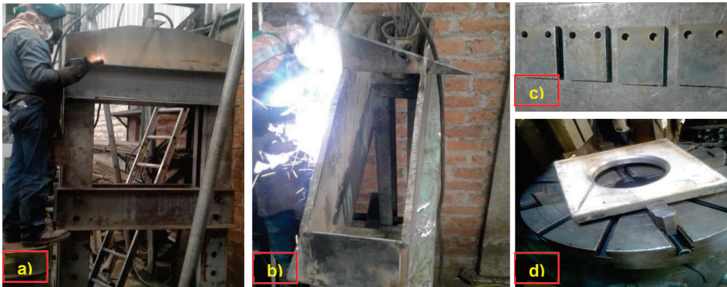
Figura 5.1. Construcción del módulo prensa: a) corte de perfil y ensamble de prensa; b) soldado de sujetadores; c) placas metálicas con perforaciones y d) placa de la camisa del cilindro.
