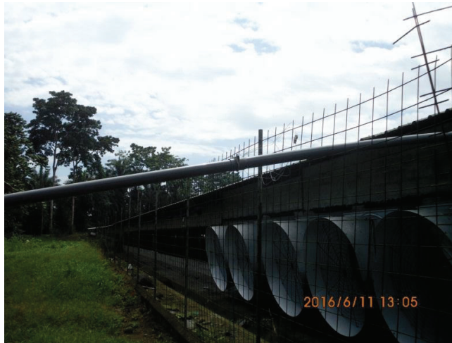
Figura 2.9. Vista exterior de los extractores de un galpón de túnel, (Fuente: Autor)
