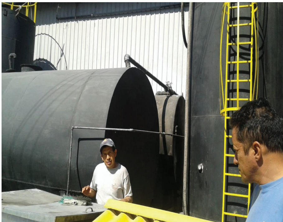
Fig. AII.10 Tanques de almacenamiento de aceite de soya y melaza
