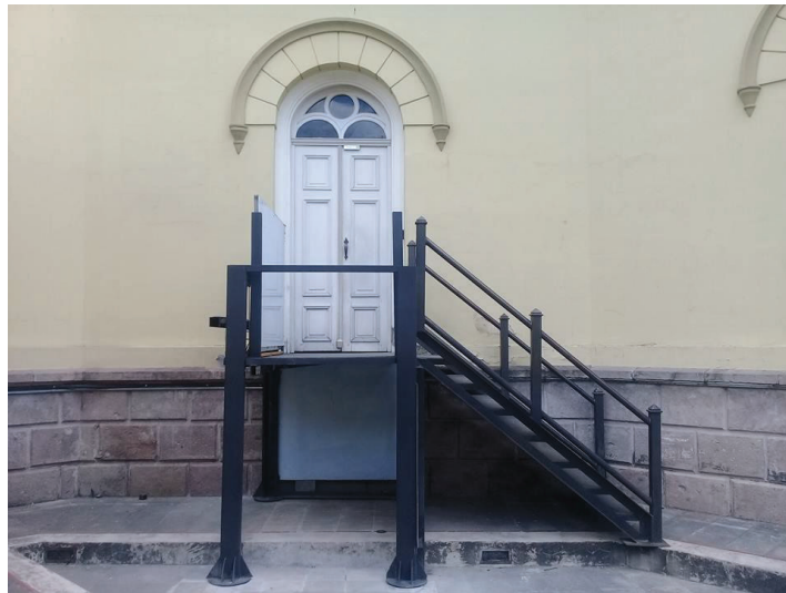
Figura 59. Salvaescaleras Vertical instalado. (Fuente: Propia)
