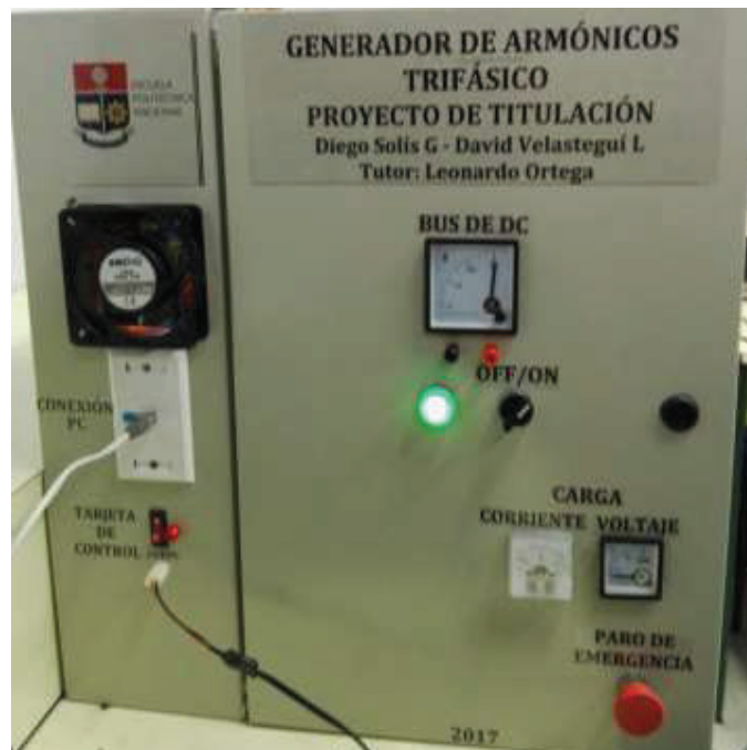
Figura 2.77 Sistema completo montado en gabinete metálico vista exterior
