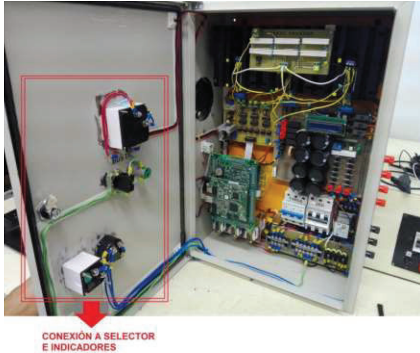
Figura A.2 Conexión al selector e indicadores de voltaje y corriente en el gabinete metálico
