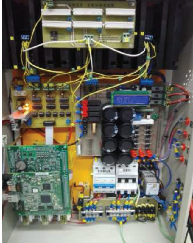
Figura 2.76 Sistema completo montado en gabinete metálico vista interior
