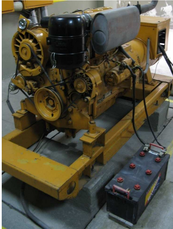
Figura A.3. 15 Generador Eléctrico N°2
