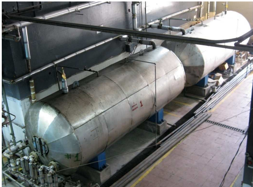
Figura A.3. 12 Tanques de agua Caliente N°1 y N°2
