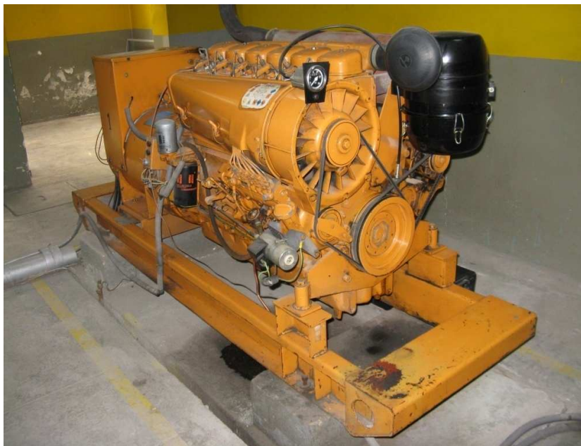
Figura A.3. 14 Generador Eléctrico N°1
