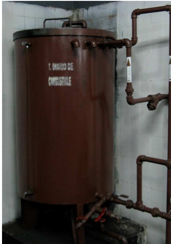
Figura A.3. 13 Tanque Diario de Combustible
