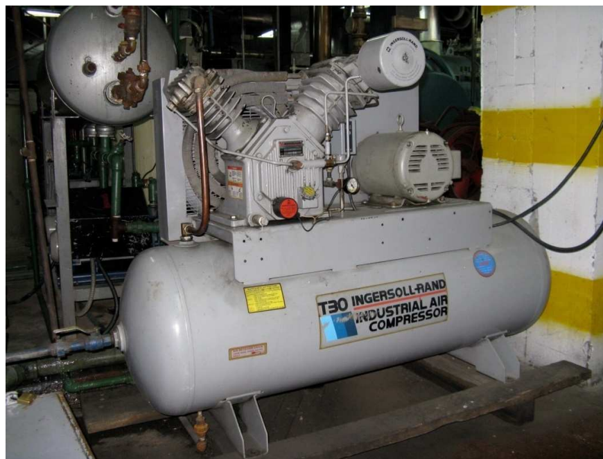
Figura A.3. 10 Compresor de Aire
