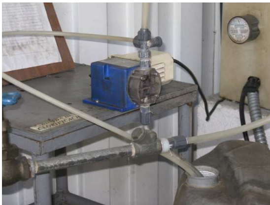
Figura A.3. 18 Bomba Clorificadora de Agua
