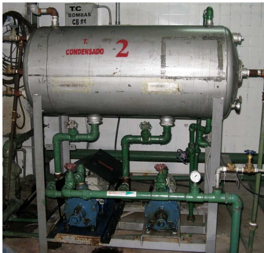
Figura A.3. 8 Tanque de Condensado N°2 y Bombas de Agua para Calderos N°4 y N°5
