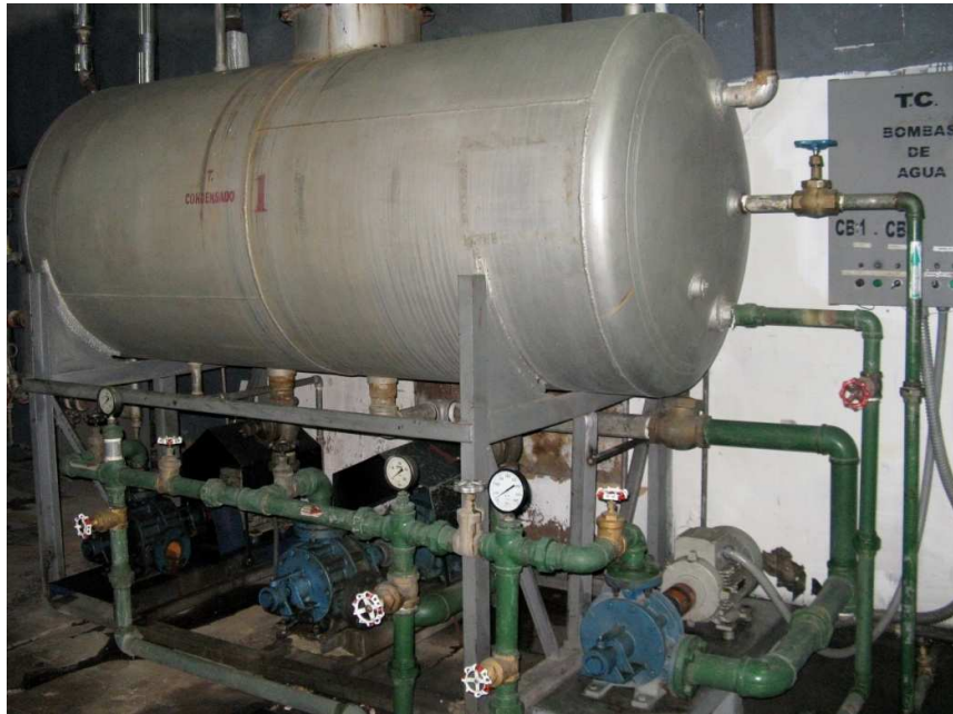
Figura A.3. 7 Tanque de Condensado N°1 y Bombas de Agua para Calderos N°1, N°2 y N°3
