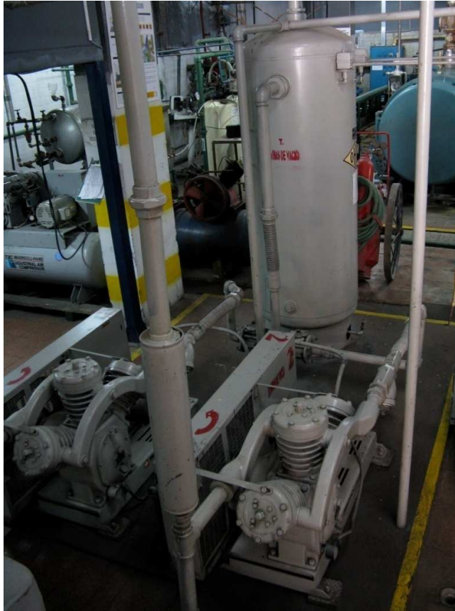
Figura A.3. 11 Bombas de Vacío
