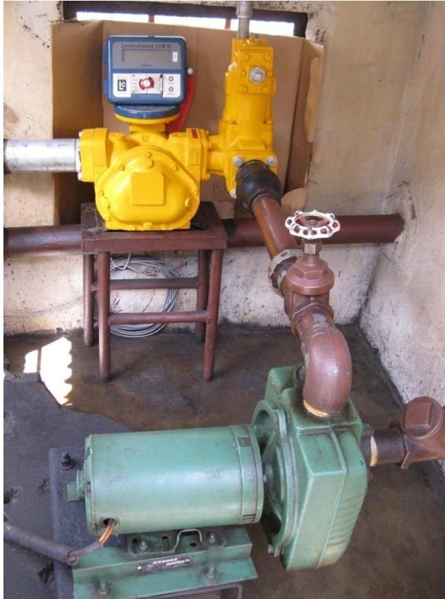
Figura A.3. 17 Contador de Combustible y Bomba de Recepción de Combustible
