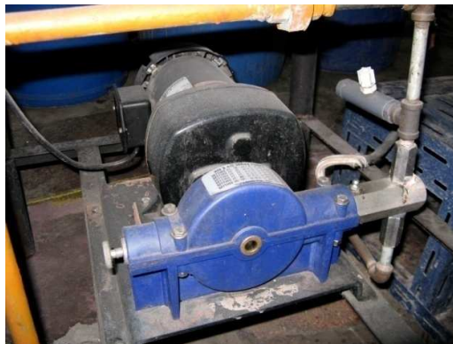
Figura A.3. 6 Bomba Dosificadora de Químico
