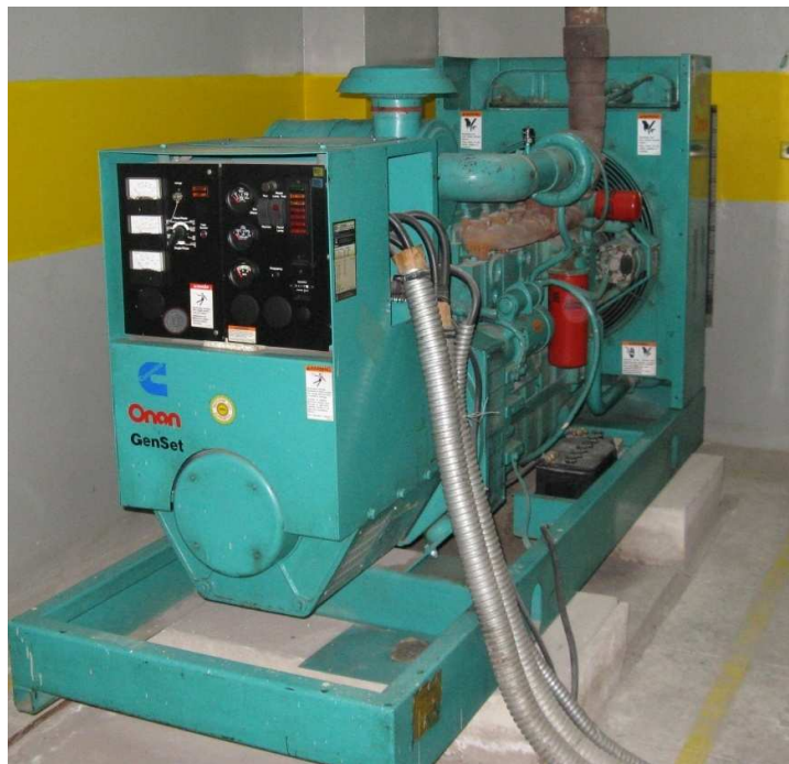
Figura A.3. 16 Generador Eléctrico N°3
