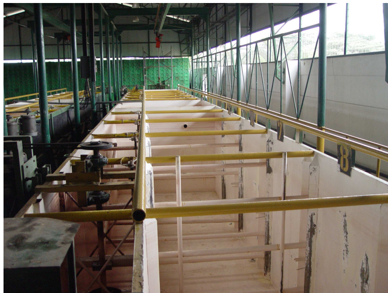
Figura 9. Planta de tratamiento hidro térmico para el mango
