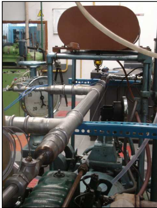
Figura 5.13. Montaje del sistema de precalentamiento de combustible.
