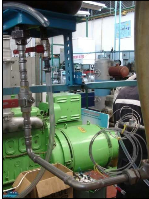
Figura 5.14. Accesorios usados para acoplar el tanque de combustible con el intercambiador de calor.
