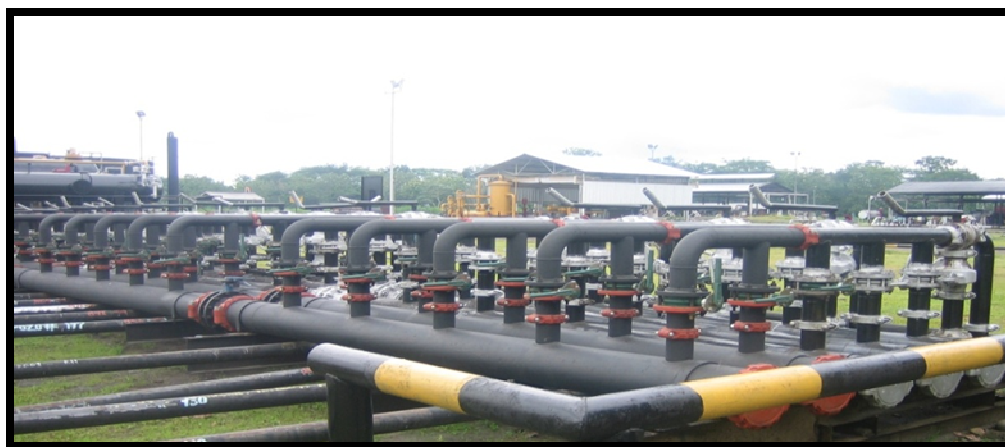
Foto 1.1 Manifold estación Sacha Central
