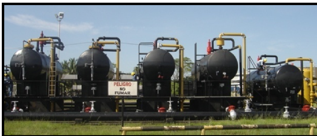
Foto 1.2: Separadores de producción estación Sacha Central
