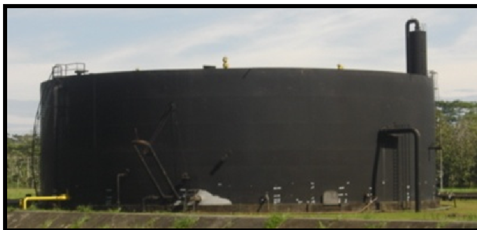
Foto 1.3: Tanque de lavado estación Sacha Central
