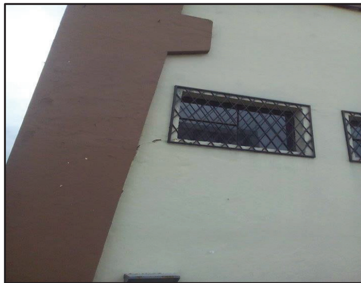
Figura 3.10: Fisura producida por orientación de las ventanas
