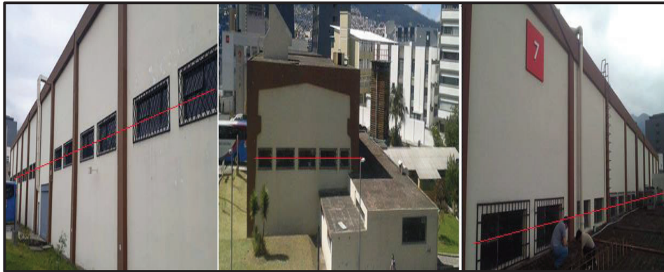
Figura 3.9: Plano de falla horizontal (Vista exterior)
