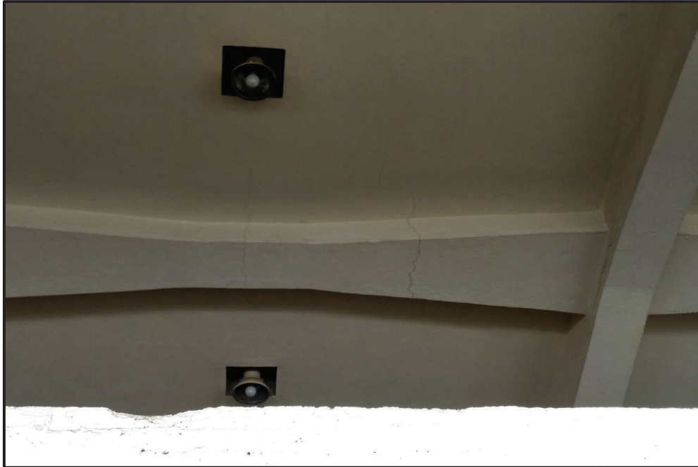
Fotografía 1: Presencia de fisuras en vigas centrales
