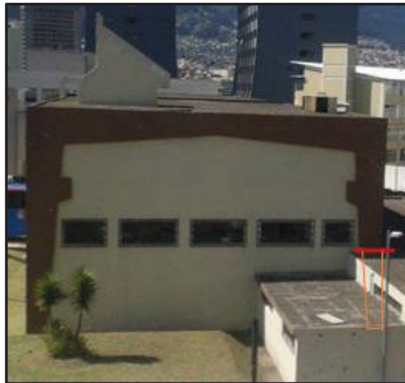
Figura 3.7: Posible efecto de columna corta por presencia de estructura aledaña y por la ubicación de las ventanas
