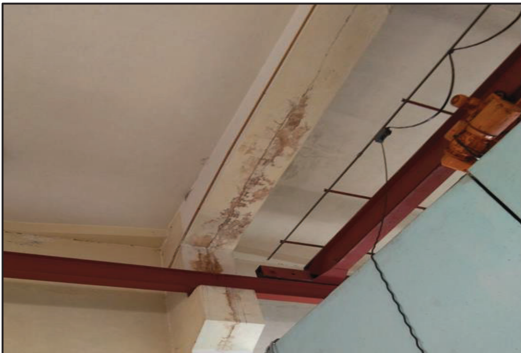
Fotografía 2: Presencia de fisuras en vigas del pórtico
