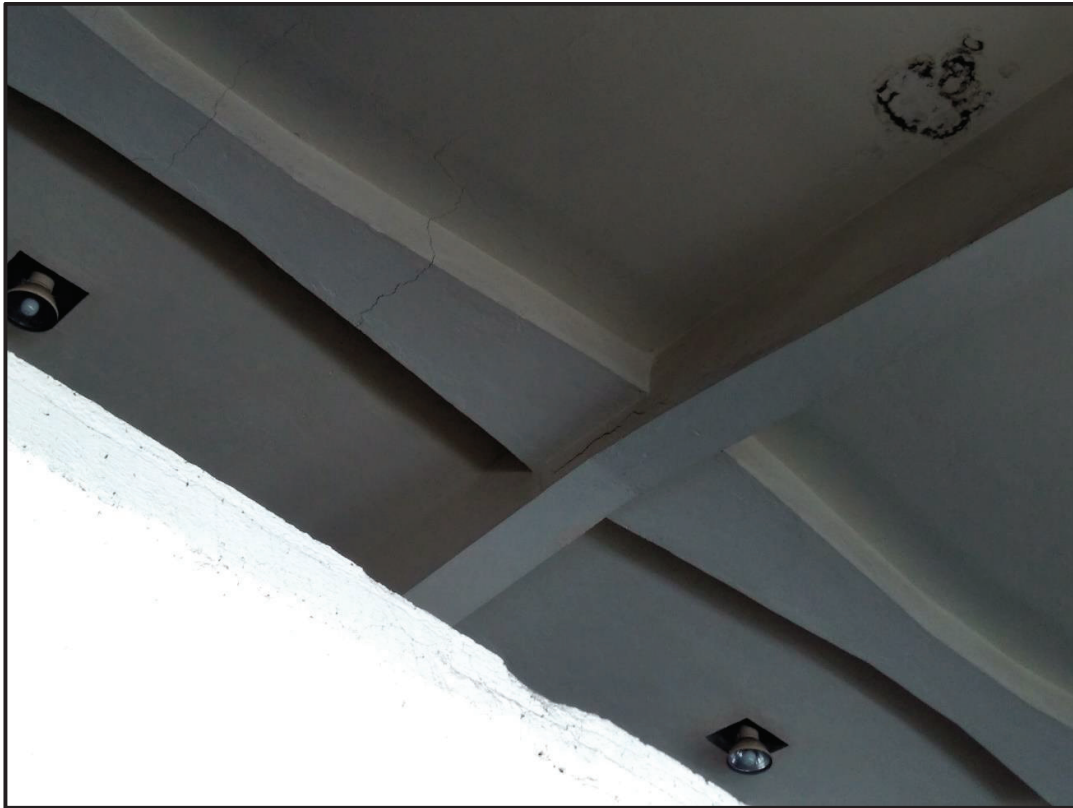
Fotografía 3: Presencia de fisuras en vigas
