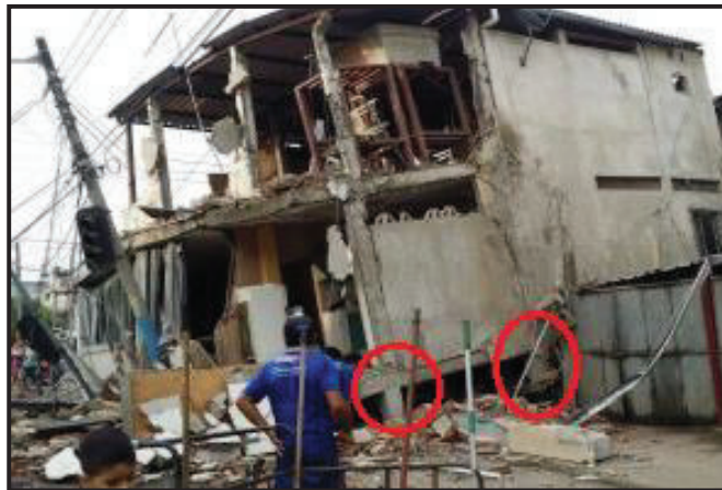
Figura 2.21: Piso blando – evento sísmico
