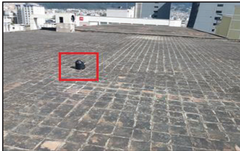
Figura 3.63: Ubicación del equipo en la parte alta de la estructura Galpón N°7 “Casa Mata”
