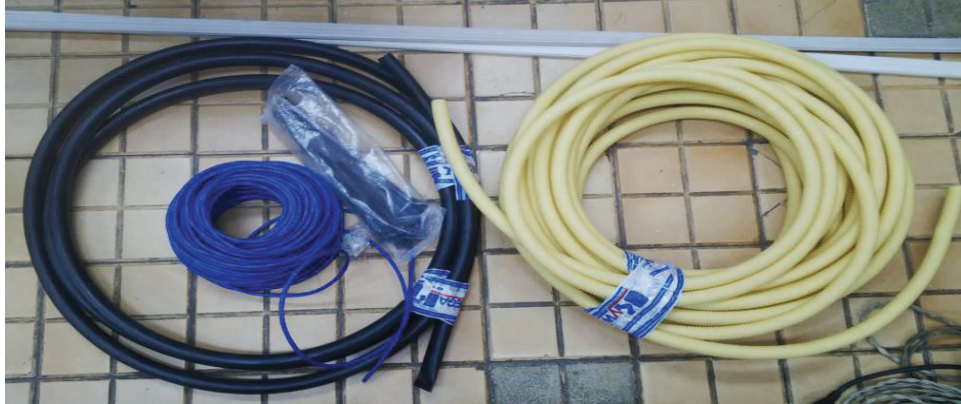
Figura 17 Material para el cableado horizontal
