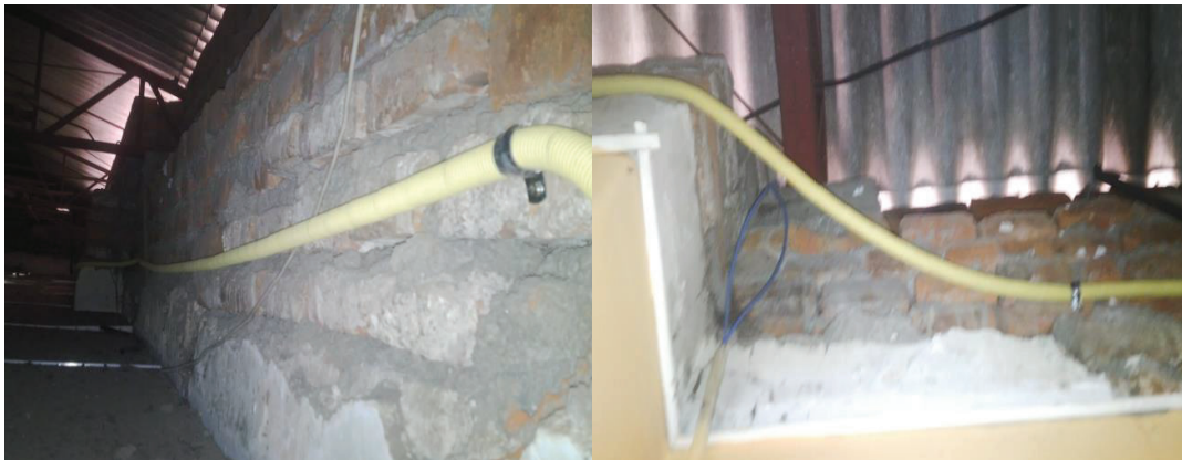
Figura 18 Tubería sobre cielo falso hacia las cámaras
