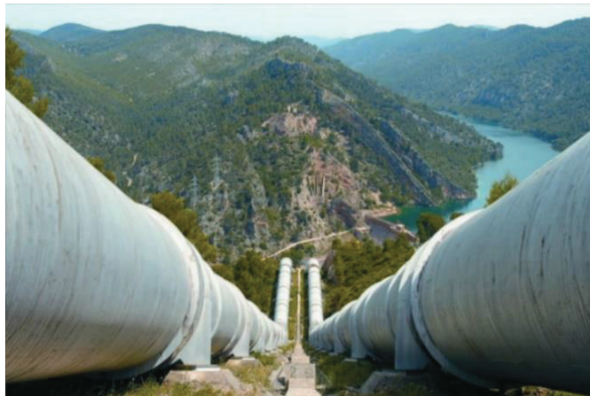
Fotografía 9. Tuberías de presión exteriores en la zona de Bolarque del Tajo – Segura (España). (Fuente: Centro de estudios hidrográficos, 1998c)
