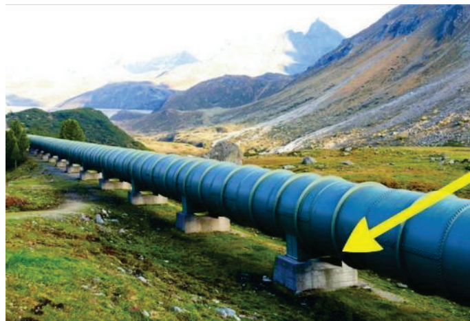
Fotografía 10. Tubería externa sobre apoyos anclados a la superficie. (Fuente: Instituto Argentino de la Energía, 2015)
