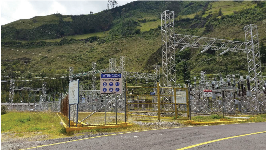
Fotografía D1. Subestación eléctrica Pucará 13.8/138 kV en conexión al SNI
