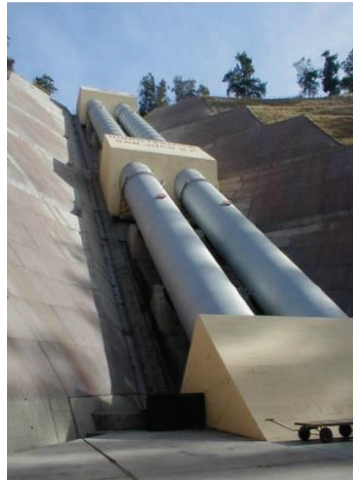
Fotografía 11. Tuberías de presión sobre puntos de anclaje. (Fuente: Instituto Argentino de la Energía, 2015)
