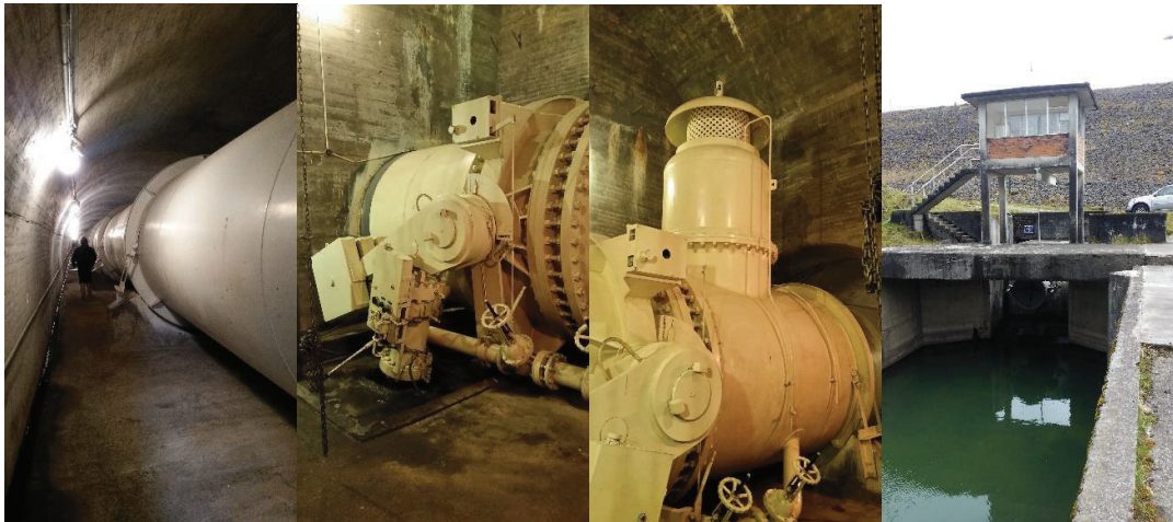
Fotografía D10. Túnel, tubería, válvulas de control y desfogue de desagüe de embalse Pisayambo
