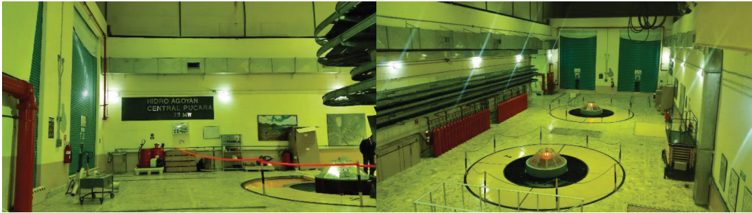
Fotografía D3. Casa de máquinas Central Hidroeléctrica Pucará
