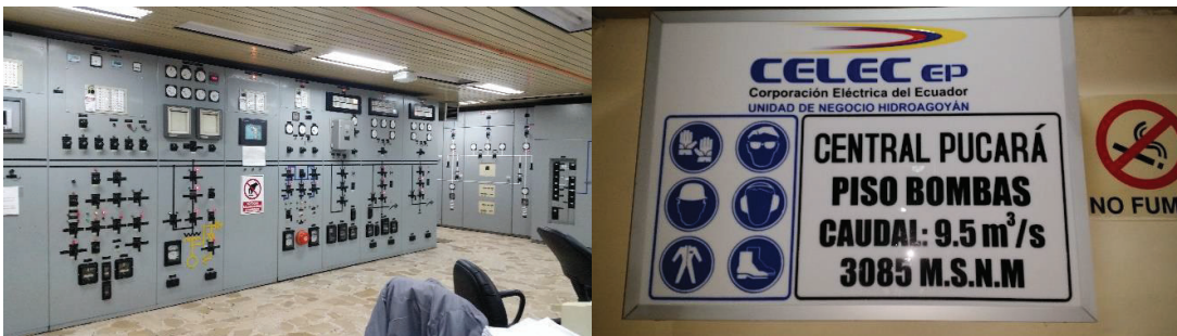
Fotografía D7. Sala de control y acceso a niveles inferiores casa de máquinas
