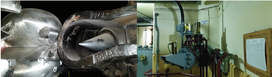
Fotografía D5. Inyector N° 5 en interior y exterior de U1
