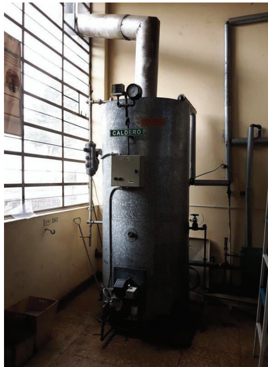
Figura 3.7 Fuente fija de combustión: Caldero del Laboratorio de operaciones unitarias de la FIQA de la EPN
