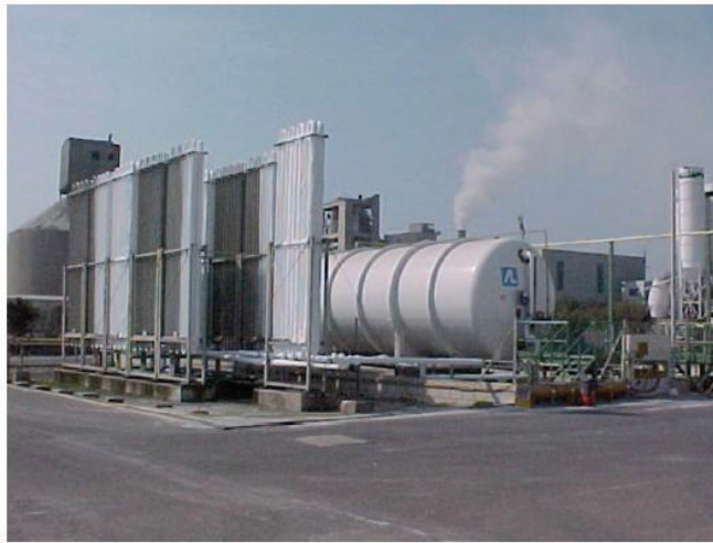
Figura 2.36: Vista de una Planta Satélite Industrial. Fuente: Sedigas, 2012.
