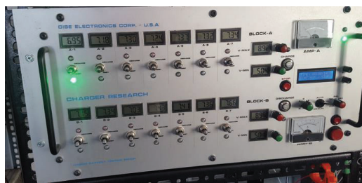
Figura 9. Descarga de la batería a 5V.
