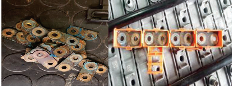
Figura 7. Contactos de batería sulfatados. (Fuente: Los autores)
