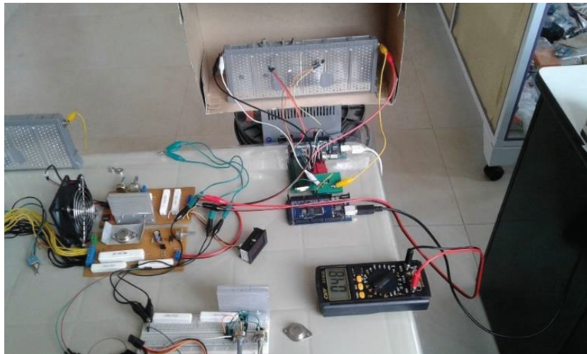
Figura 22. Conexiones de la celda al cargador individual. (Fuente: Los autores)
