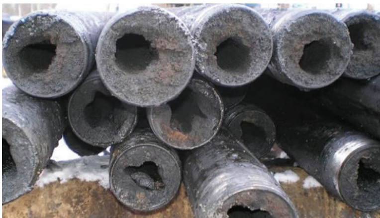
Figura 9. Tubería que ha sufrido un proceso de precipitación y depositación de parafina y asfaltenos (Oil Production.net, 2016)
