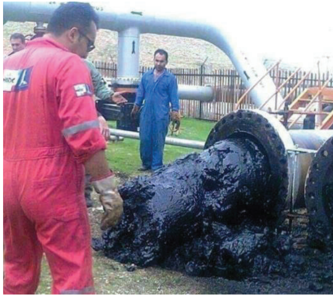
Figura 8. Taponamiento de tubería por problemas ocasionados por asfaltenos (Shah Abdul Latif Health & Safety, 2017)
