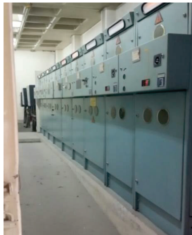
Figura 3.12. Transformadores Eléctricos. (Fuente: propia).
