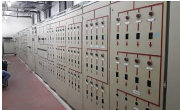
Figura 3.13. Tableros de distribución. (Fuente: propia).
