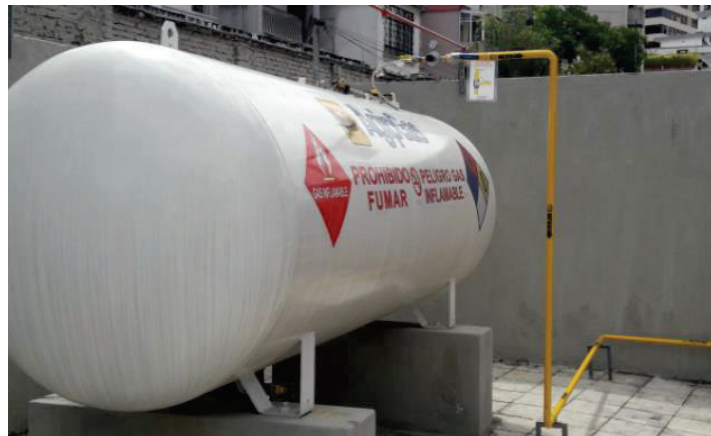
Figura 3.22. Tanque acumulador GLP. (Fuente: propia)
