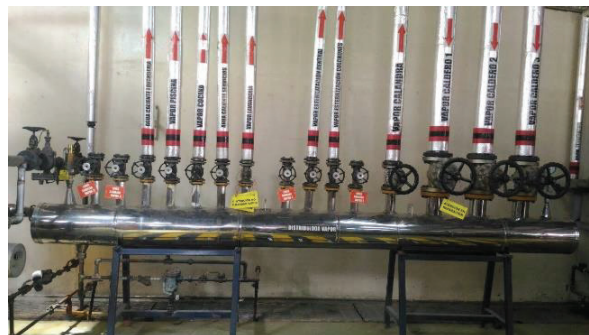
Figura 3.20. Distribuidor de vapor. (Fuente: propia).
