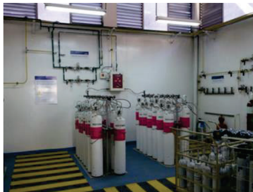
Figura 3.25. Central de gases medicinales. (Fuente: Propia)
