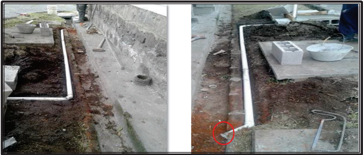
Figura 18. Reacondicionamiento de la zona peatonal e instalación de rejilla en la línea de desagüe (resaltado en rojo)
