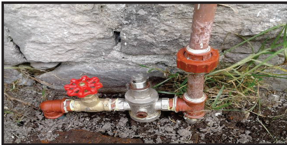
Figura 15. Válvula instalada en la zona de conexión con la red municipal
