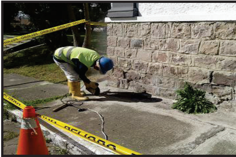
Figura 14. Rotura zona de tránsito peatonal
