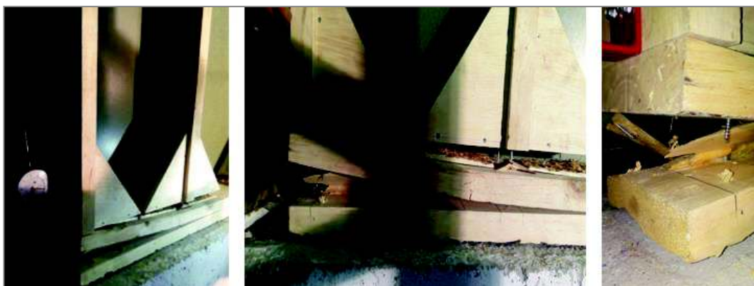
FOTOGRAFÍA 5.7 DESGARRAMIENTO DE ESCUADRA Y LEVANTAMIENTO DE SOLERA INFERIOR ALCANZADA LA CARGA MÁXIMA.
