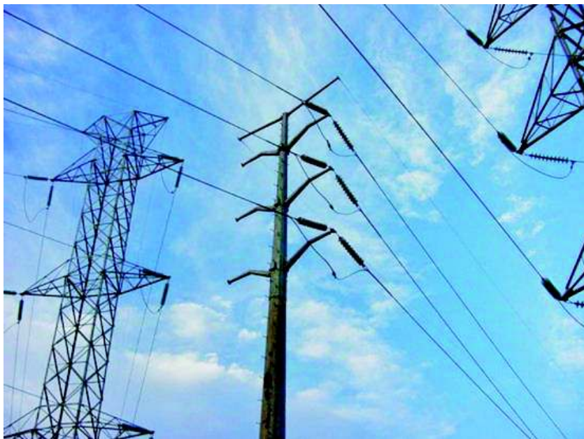
Figura 2.5. Línea de transmisión vista desde una torre [Elaboración propia].
