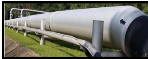
Figura 13 – Oleoducto de crudos pesados (Líderes, 2015)
