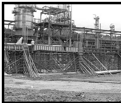
Figura 4 – Infraestructura de producción de campos petroleros (El Comercio, 2012)
