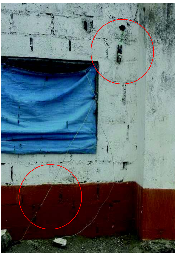
Figura 23. Protecciones inadecuadas del circuito de iluminación Fuente: Propia
