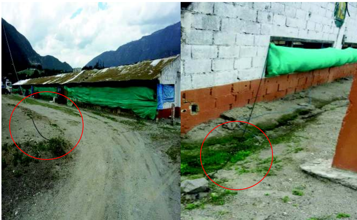
Figura 24. Canalizaciones subterráneas Fuente: Propia
