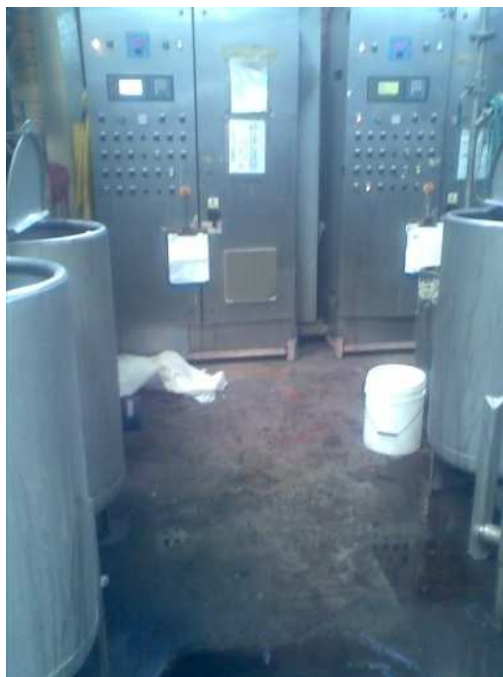
Figura 4.3.- Tableros de control MCS1 y MCS2
